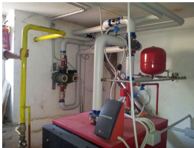
Figura 7. Centrale termica: Generatore di calore e pompe di circolazione
