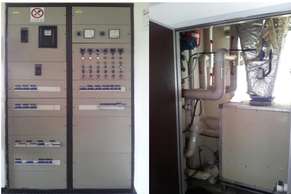
Figura 15: Quadro elettrico e sottocentrale termica dell'edificio.
