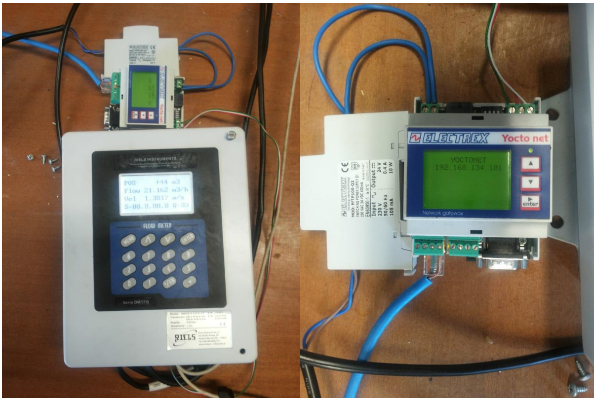
Figura 95 –Strumento di misura affiancato all'interfaccia di rete MODBUS su TCP/IP
