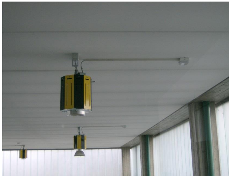
Figura 4: La Hall tecnologica con i nuovi apparecchi installati
