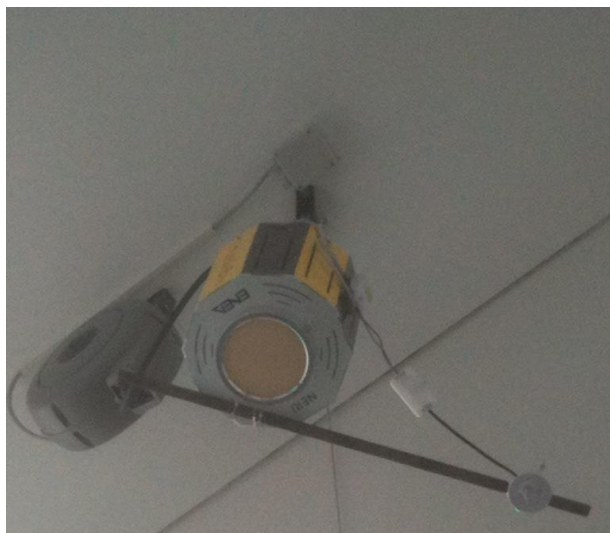
Figura 24: Collocazione del sensore di presenza e fotosensore in prossimità del prototipo
