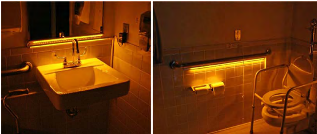
Figura 16 - Sistema di illuminazione ambra installato all'interno del bagno
