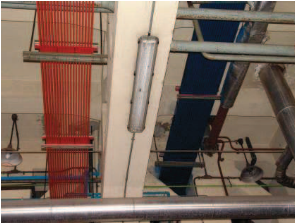
Fig. 41 – Sbarratura in rame
