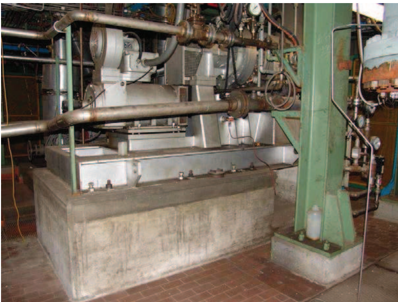
Figura 14 – Pompa di ricircolo
