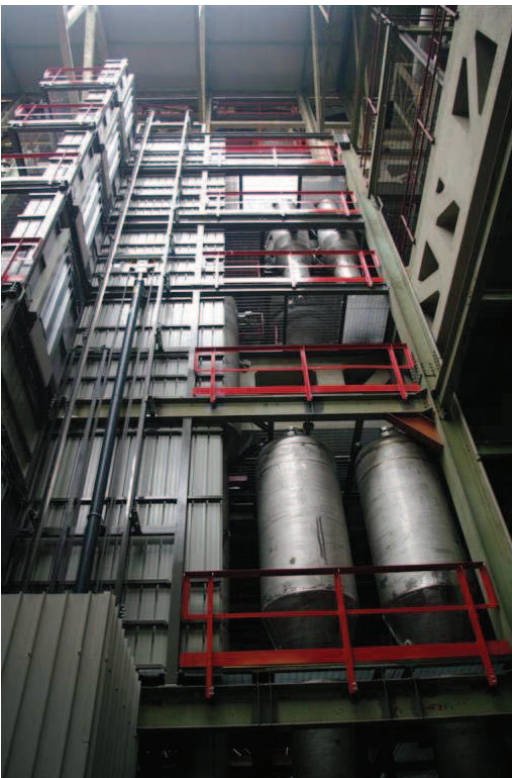
Figura 5 – Impianto SPES-3 nello stato attuale di avanzamento
