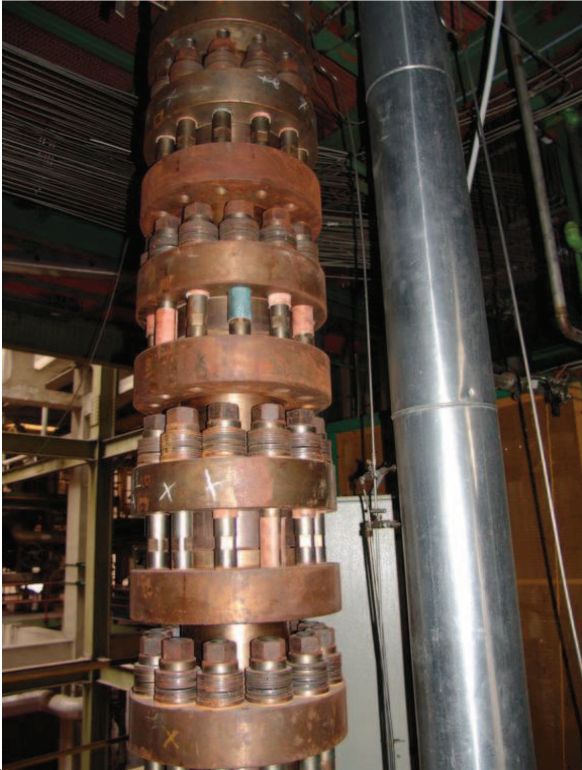
Figura 9 – Tratto flangiato del canale di potenza SPES-2
