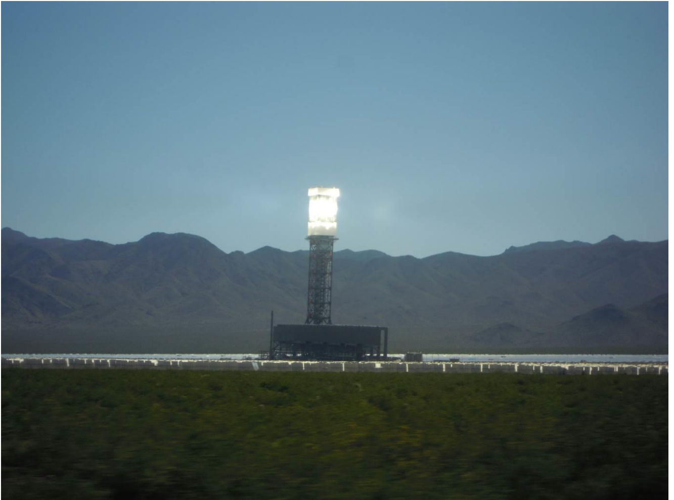
Figura 3. altra veduta del ricevitore sotto irraggiamento
