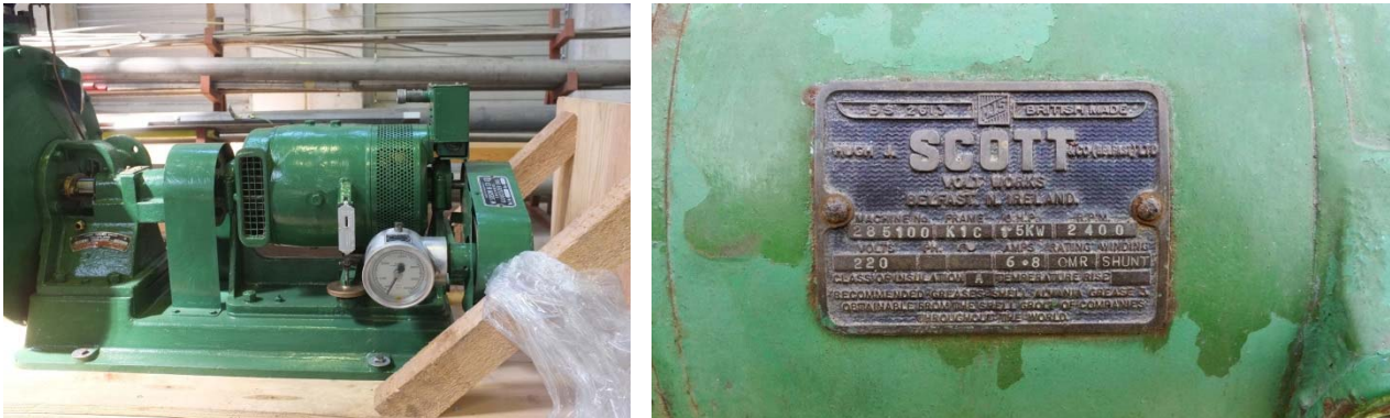
Figura 16: Turbogeneratore Sissons Ltd. - particolare del generatore elettrico, sinistra; targa del generatore elettrico 220 V CC, destra (prima della revisione)
