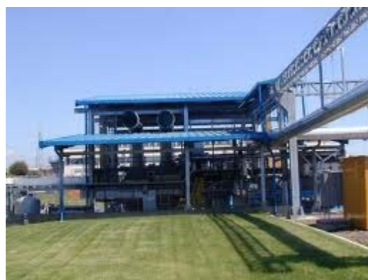
Figura 2: Vista del capannone che ospita l'impianto per la produzione di vapore
