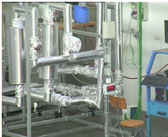
Figura 1- Scorcio dell'impianto ATES in Enea Casaccia (Roma)
