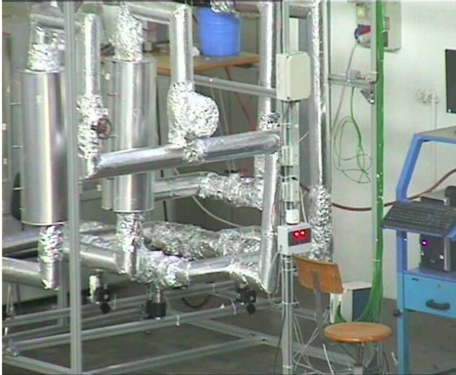
Figura 6 – Impianto realizzato in Casaccia
