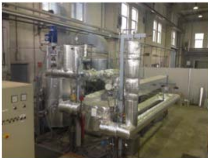
Figura 2. - impianto MOSE (ENEA).
