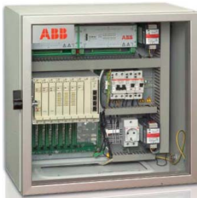
Fig. 20 - RTU (ABB, modello RTU560D)
