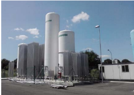
Piazzola stoccaggio serbatoi criogenici
