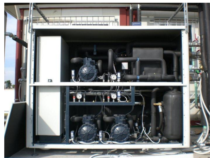
Impianto a Pompa di calore a CO 2 (R744)
