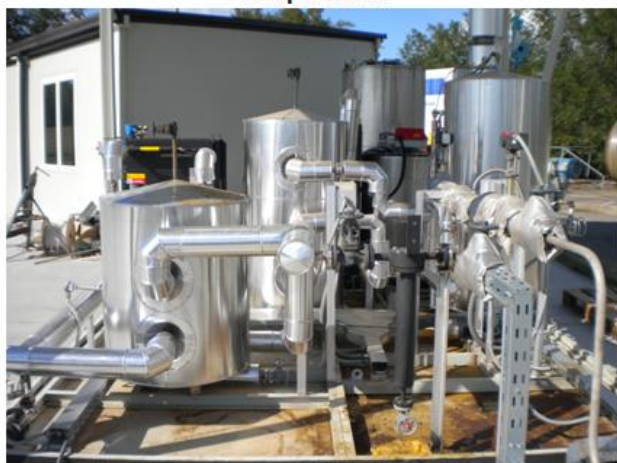
Vista frontale del circuito di prova ad olio diatermico
