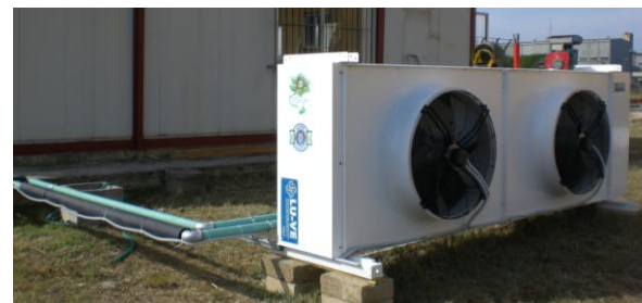
Impianto a Pompa di calore a CO 2 (R744)
