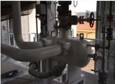
Sistema di raffreddamento: Steam drum
