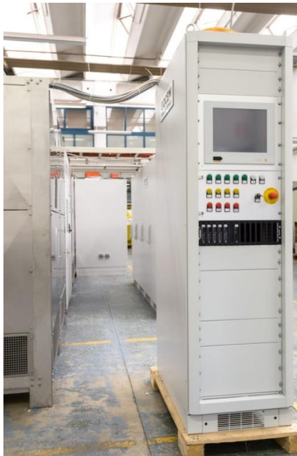
Local Control cubicle della SNU
