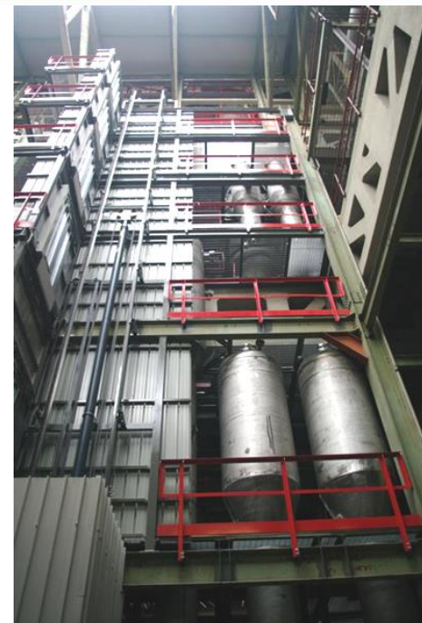
Serbatoi del contenimento SPES-3 installati sulla struttura
