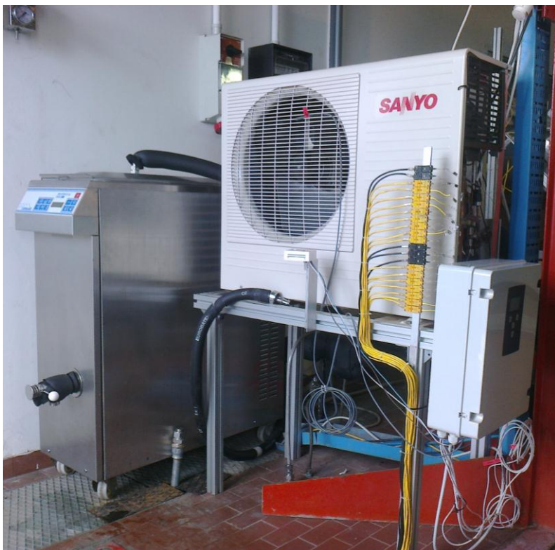
Facility di prova Impianto Pa.CO 2 (PAsteurization with CO 2 )
