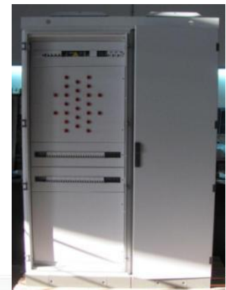
Quadro di controllo
