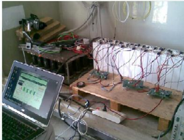
BMS n. 4 (di tipo attivo) in esercizio
