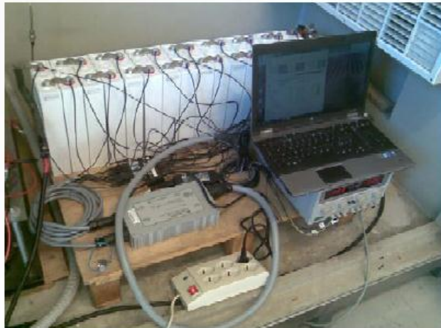
BMS n. 3 (di tipo passivo) in esercizio
