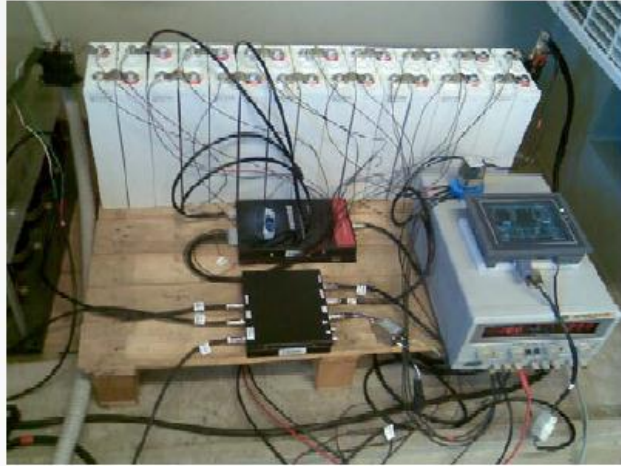
BMS n. 1 (di tipo passivo) in esercizio
